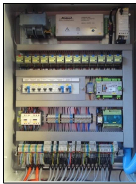
Innenleben der Steuerung
