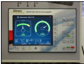
Bimex-Steuerung für Netzparallelbetrieb
