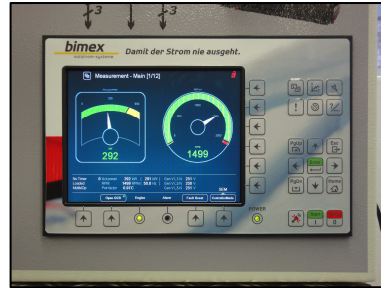
Steuerung VISION Bimex Netzparallel
