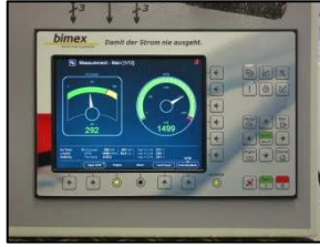
Steuerung Bimex Netzparallel
